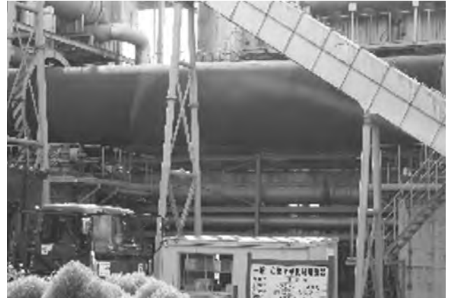
セメントキルンに似た焙焼炉。焼却灰や汚染土壌を高温焼成して無害化する。
